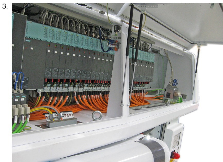
Exemple : Portes des armoires électriques d'un multibroche
