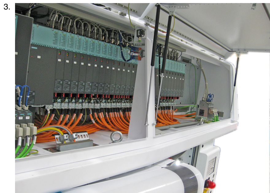
Exemple : Portes des armoires électriques d'un multibroche
