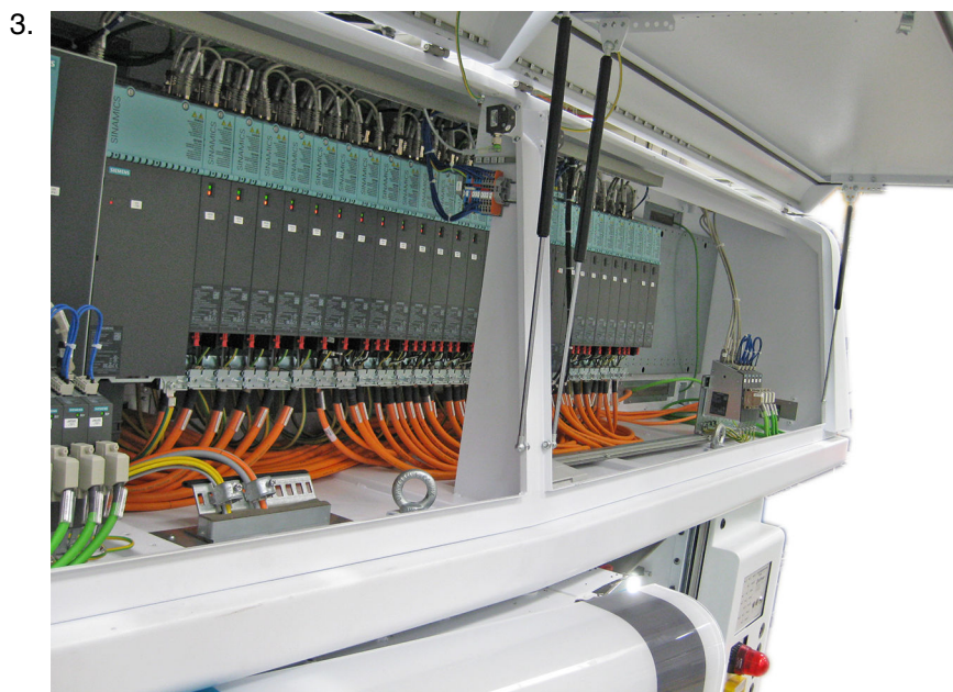
Exemple : Portes des armoires électriques d'un multibroche
